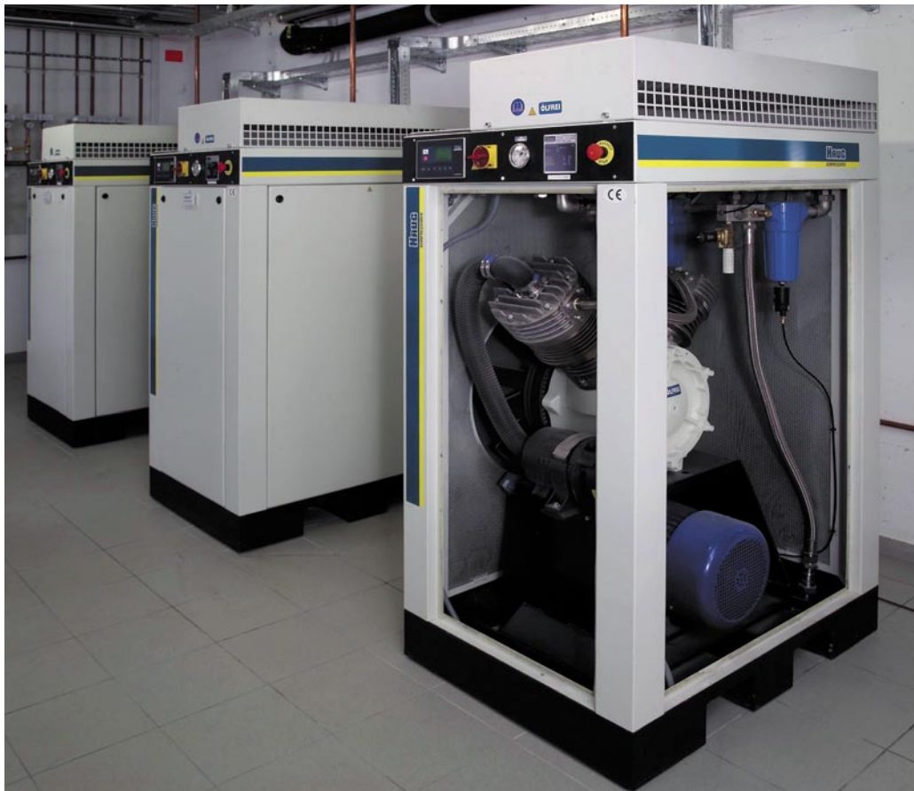
Primär-, Sekundär- und Reserveversorgung mit drei öllösen Kompressoren von Haug. (Liefermenge 80Nm 3 /h bei 10bar Enddruck)
