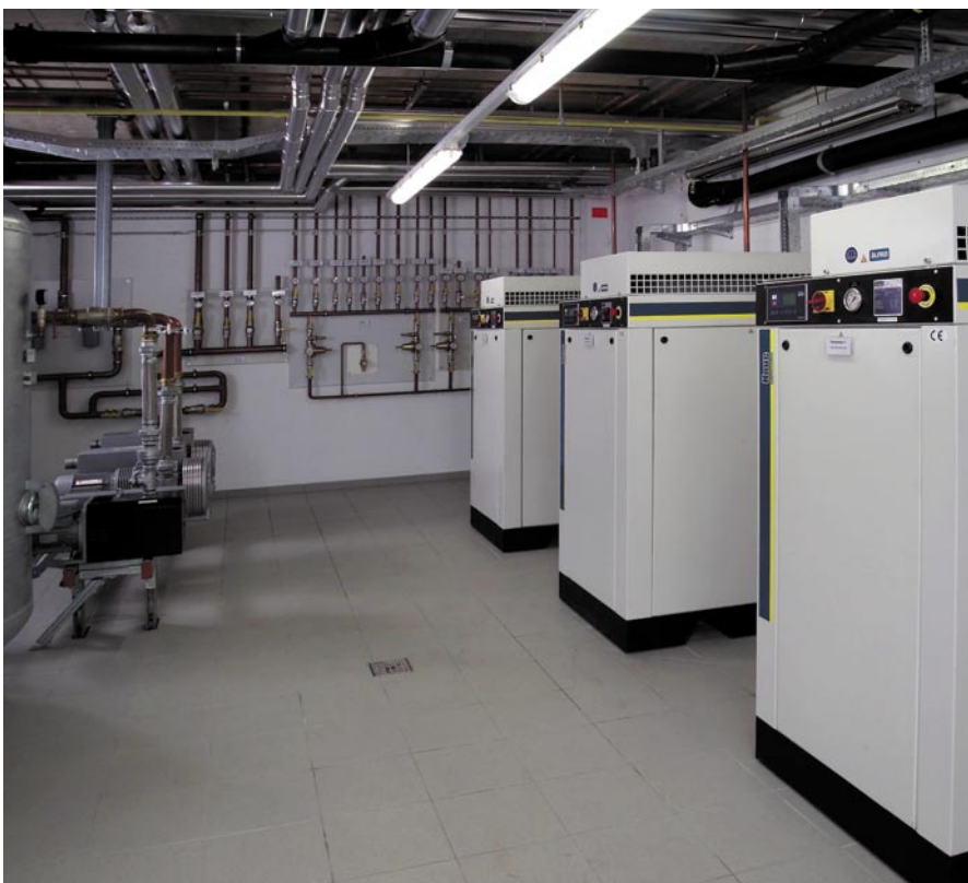
Die Druckluft- und Vakuumpumpe des Landeskrankenhauses Bregenz. (AT)
