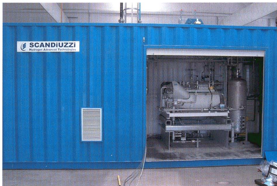
Bild 1: Anlage für die Erzeugung reinen Wasserstoffs mit einem Kompressor von HAUG
