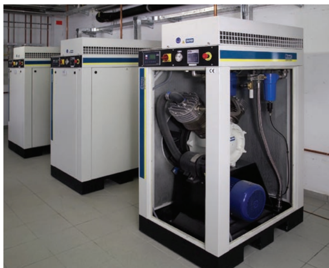
Druckluftzentrale des Landeskrankenhauses Bregenz
