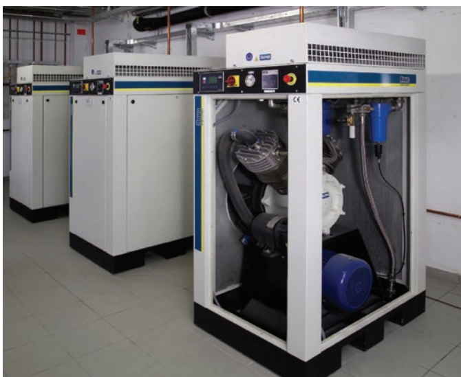
Druckluftzentrale des Landeskrankenhauses Bregenz
